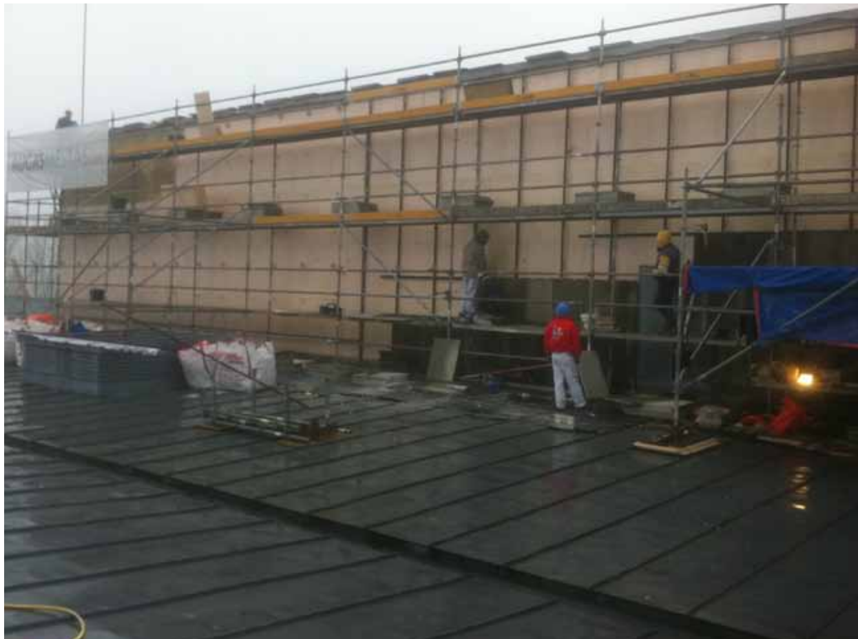
El Palacio de Congresos y Exposiciones de Galicia estaba afectado por las filtraciones del agua de la lluvia
